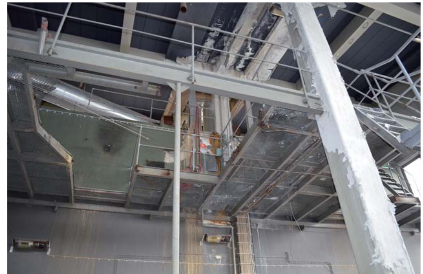
Kuva 3. Kattilahalli on pahasti rapautunut.
