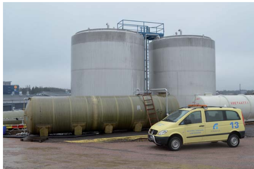
Kuva 25. Vanhat kevytöljysäiliöt (taustalla) ja uudet kemikaalisäiliöt
